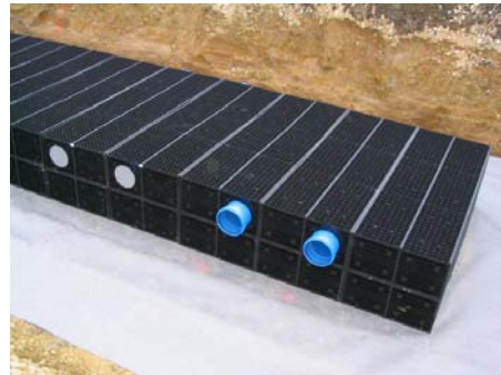
Photo 3.5 : Ouvrage de stockage en SAUL à diffuseur interne sous chaussée Réseau de drainage raccordé au droit de branchements : avaloir EP de voirie, branchement EP particulier.
