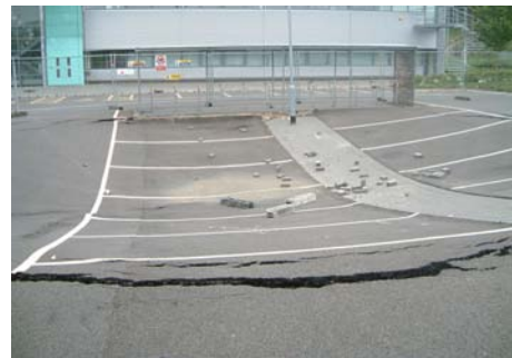
Photo 2.13 : Effondrement d'un ouvrage en SAUL sous un parking [CIRIA, 2008]
