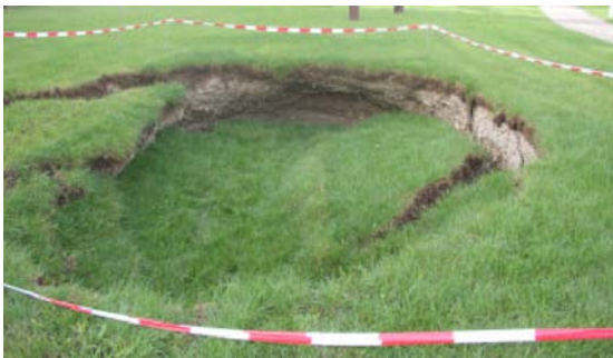
Photo 2.12 : Cône d'effondrement au-dessus d'un ouvrage en SAUL [Paul, 2006]
