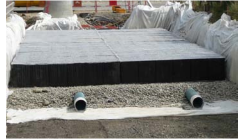
Photo 3.2 : Exemple de SAUL à diffuseur externe
